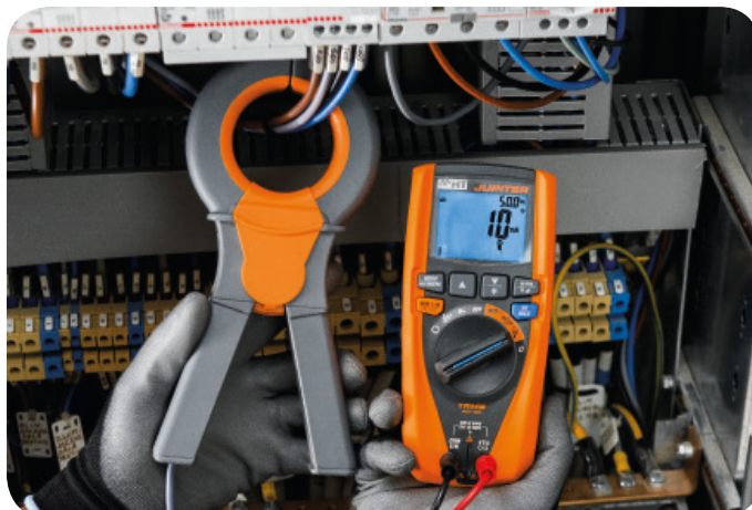
Fehlerstrommessung mit HT96U
