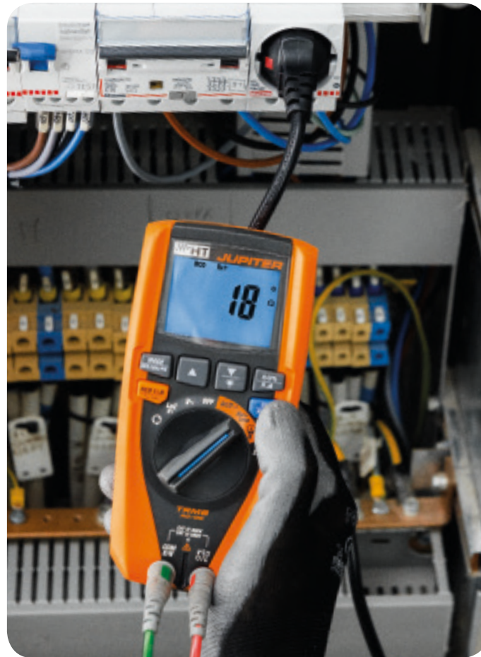
Impedanzmessung ohne RCD-Auslösung
