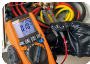
Durchgangsprüfung von Schutzleitern.
